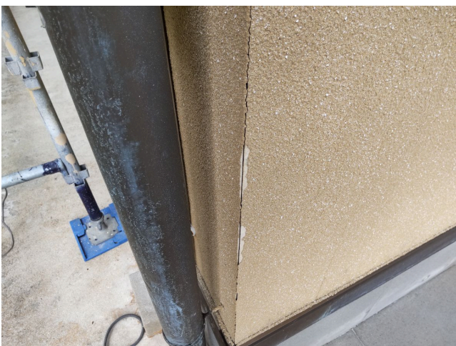
外壁 剥離箇所
