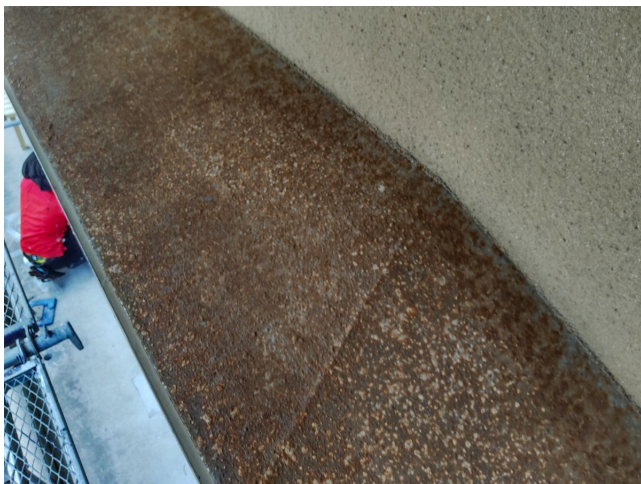
出窓 天板 腐食状況
